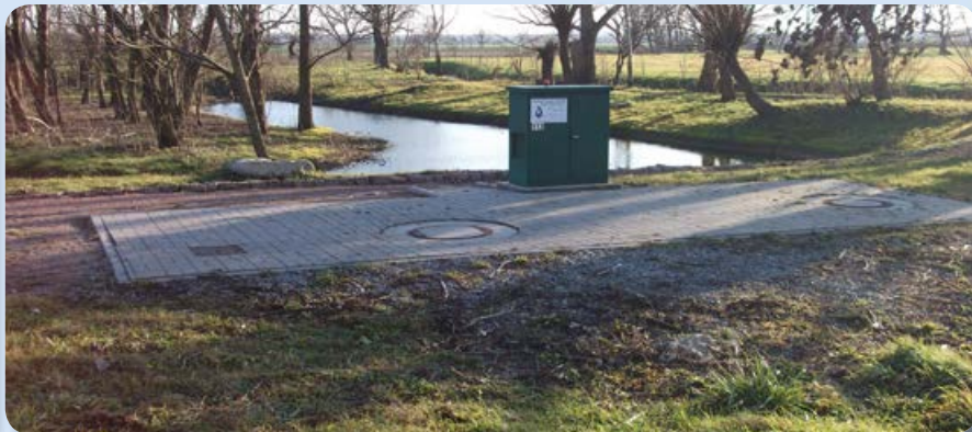
Gruppenkläranlage in Pfitzdorf
