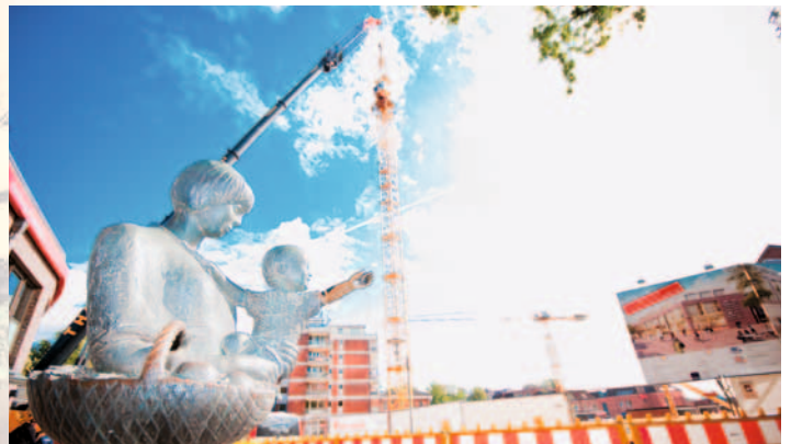
Auf dem großen Kran auf der Baustelle der Buchholz Galerie wird die Spitze mit der Führerkabine montiert
