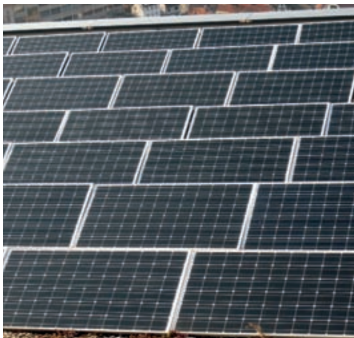
Solaranlage auf Flachdach
