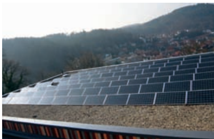
Solaranlage auf einem öffentlichen Gebäude © Landratsamt Calw
