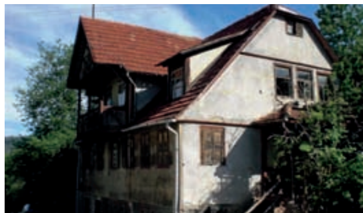
Altbestand mit möglichen schadstoffhaltigen Abfällen
