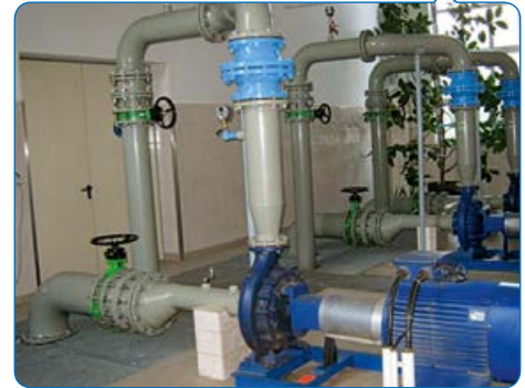
Wasserwerk Lübbenau/Spreewald Reinwasserpumpwerk neu – März 1993
