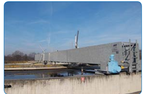
Kläranlage Lübbenau/Spreewald neu – 2004
