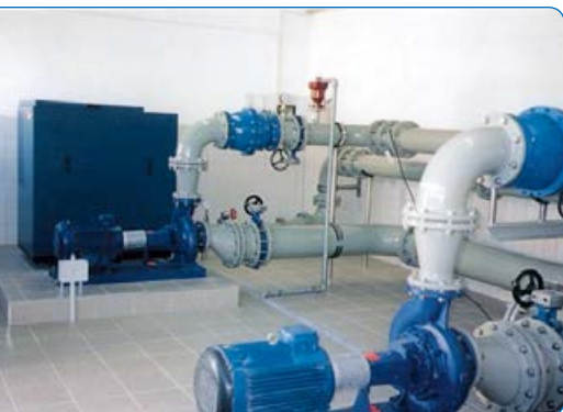
Wasserwerk Lübbenau/Spreewald Rohwasserpumpwerk neu – 1996
