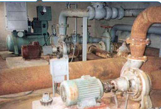
Wasserwerk Lübbenau/Spreewald Rohwasserpumpwerk alt
