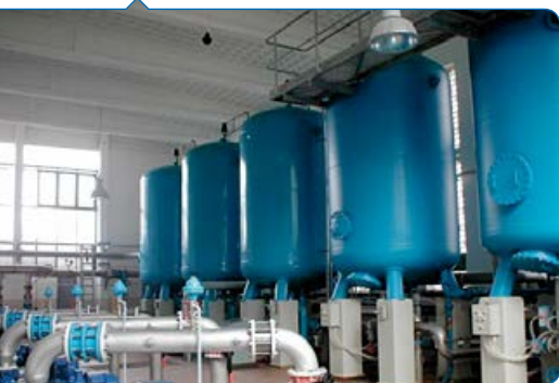
Wasserwerk Vetschau/Spreewald Filterhalle neu – 1997/2012
