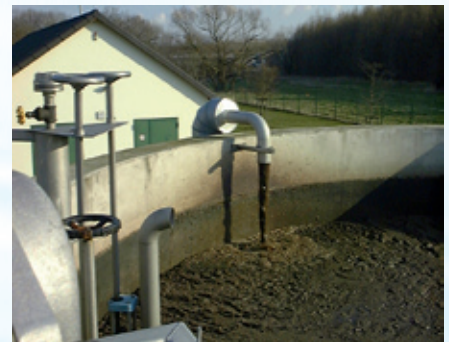
Foto: ZAL, KA Lucka, Schlammsilo
