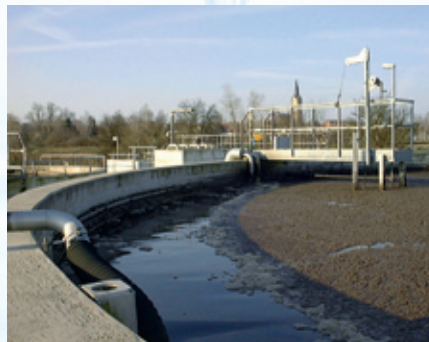
Foto: ZAL, KA Lucka, Belebungsbecken
