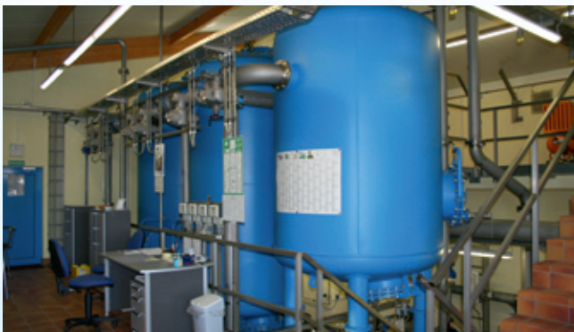
Foto: ZAL, Filteranlage, VWV Merlach
