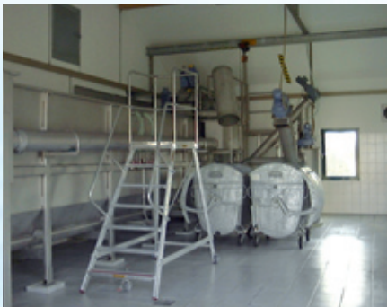
Foto: ZAL, KA Gößnitz, Rechenhaus mit Kompaktanlage
