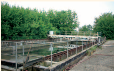
Kläranlage Tangerhütte Nachklärbecken alt
