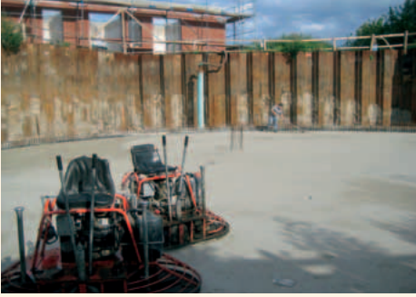
Kläranlage Tangerhütte Belebungsbecken
