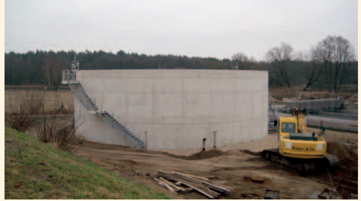
Kläranlage Tangerhütte Schlamm Speicher neu
