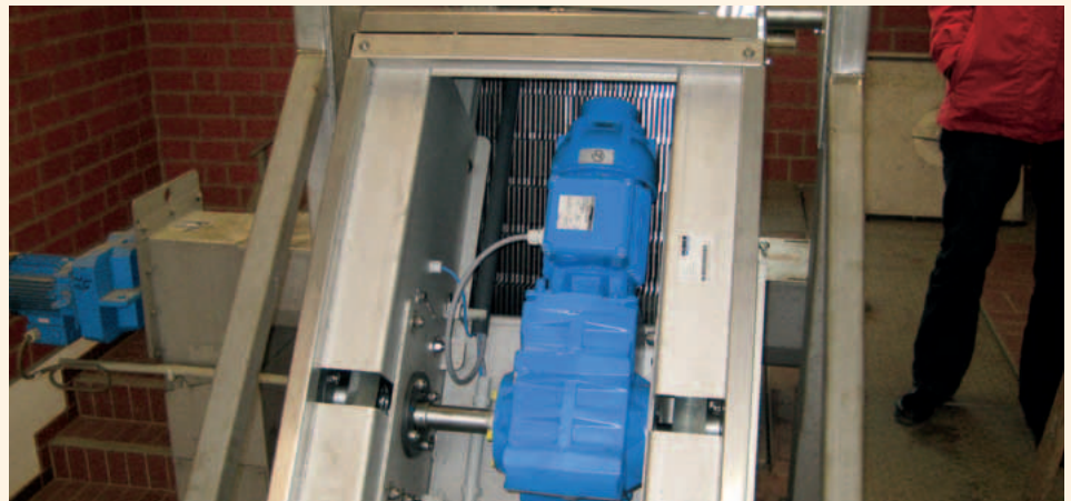
Kläranlage Tangerhütte Rechenanlage
