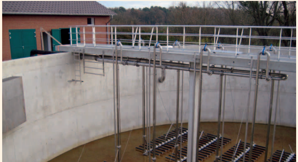
Kläranlage Tangerhütte Belüftung
