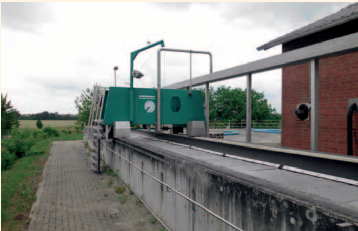
Kläranlage Tangerhütte Sandfang
