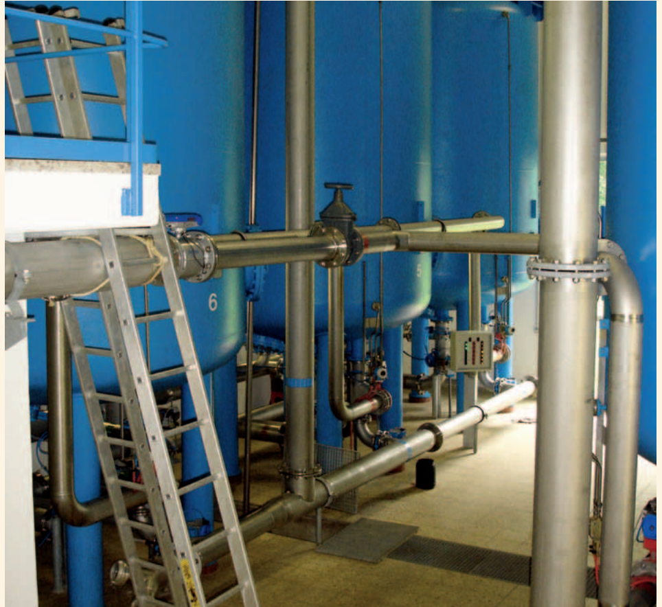
Wasserwerk Osterburg Filteranlage
