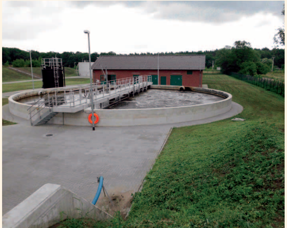
Kläranlage Tangerhütte Belebungsbecken
