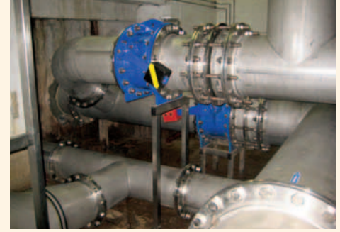
Kläranlage Tangerhütte Rohrleitungen
