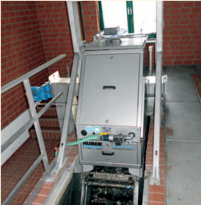
Kläranlage Tangerhütte Fäkalschlammrechen
