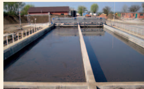
Kläranlage Tangerhütte Nachklärbecken neu
