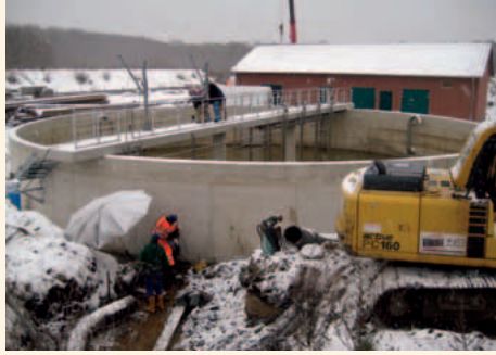
Kläranlage Tangerhütte Belebungsbecken
