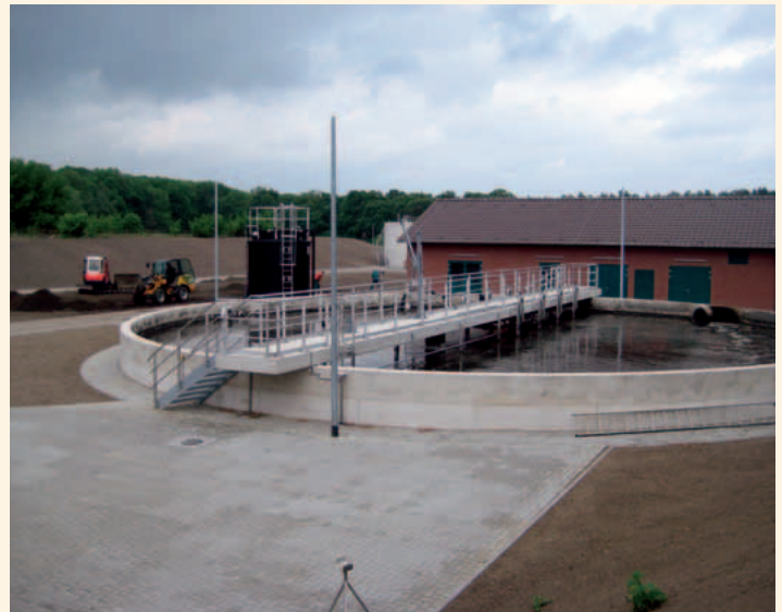
Kläranlage Tangerhütte Belebungsbecken neu
