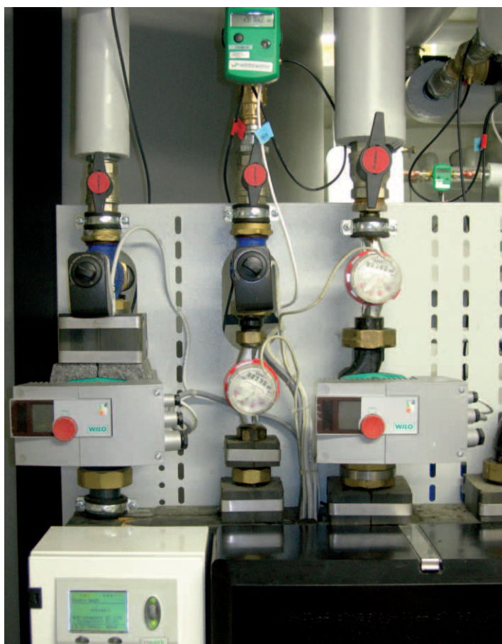
Abb. 4: Teil einer Gebäudeübergabestation mit Messeinrichtung.
