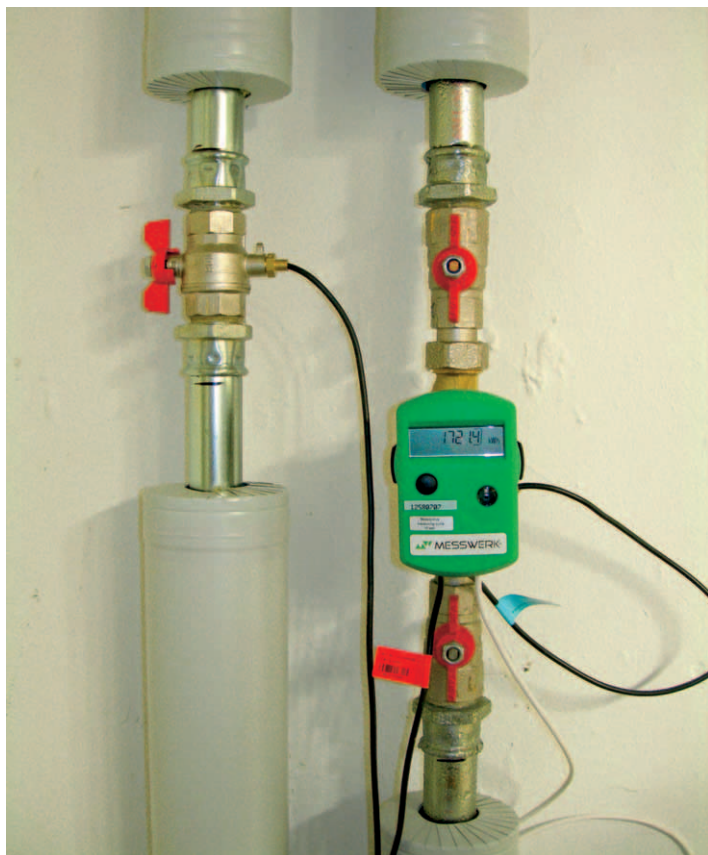
Abb. 3: Wärmemengenzähler mit Fernauslesung.
