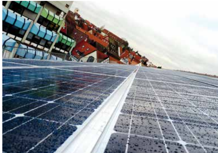
Die Solaranlage auf dem Rathausdach ist ein Bürgerprojekt.
