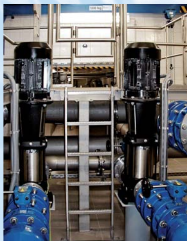
Pumpwerk im Hochbehälter „Griebse“, Pößneck
