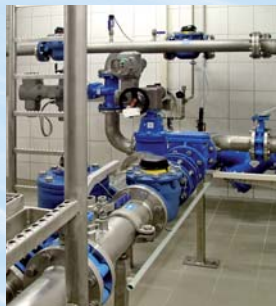
Foto: Zweckverband Neustadt an der Orla, Leitungen und Armaturen im Hochbehäl- ter Arnshaugk
