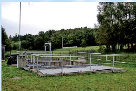
Foto: ZV, Kläranlage im Gewerbegebiet Triptis
