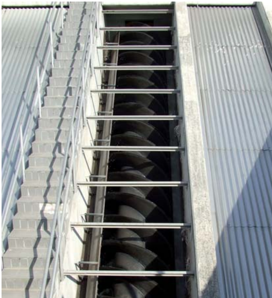
Schneckenpumpwerk am Zulauf der Kläranlage. Das Abwasser wird über eine Höhe von fast 7 Metern zur mechanischen Behandlungsstufe gefördert.
