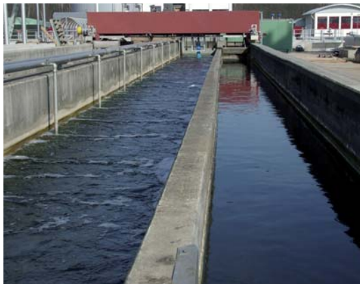
Im Sand- und Fettfang der ZKA Weidensdorf werden neben Sand und Fetten weitere Schwebstoffe aus dem Abwasserstrom abgeschieden.
