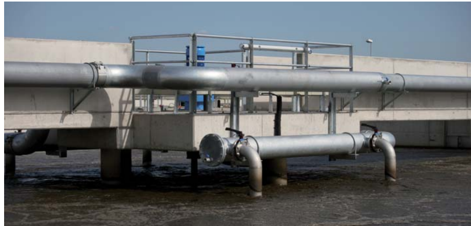
In den Belebungsbecken wird das Abwasser biologisch gereinigt. Millionen Kleinstlebewesen sorgen für den Abbau von Kohlenstoffverbindungen und die Nährstoffelimination.
