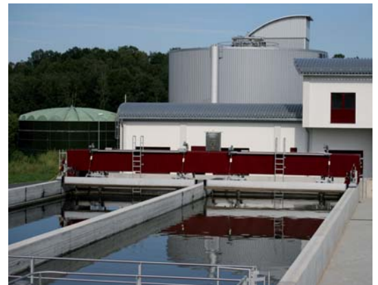
In den Vorklärbecken wird der Primärschlamm zurückgehalten und Schwimmstoffe von der Wasseroberfläche entfernt.
