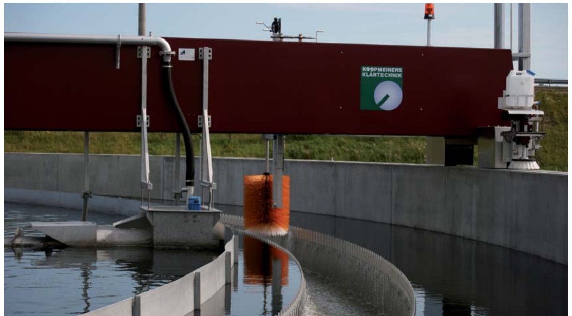
Die Nachklärung ist der letzte Schritt der biologischen Abwasserreinigung. Das Klarwasser gelangt zum Ablaufbauwerk und wird in die Vorflut – die Zwickauer Mulde – geleitet.
