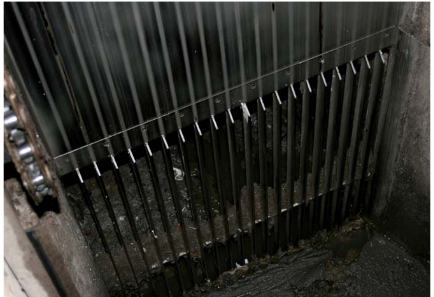
Im Rechengebäude der ZKA Weidensdorf findet eine erste mechanische Reinigung des Abwassers statt. Auf den Rechenstraßen werden grobe Inhaltsstoffe aus dem Abwasser herausgekämmt und für eine umweltgerechte Entsorgung in Containern abgelegt.
