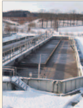
Bild 26 – Zentralkläranlage Freiberg 2006, Belebungsbecken, 1998 in Betrieb genommen
