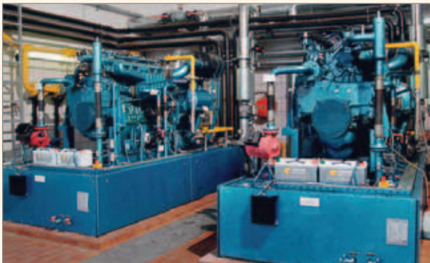
Bild 29 – Zentralkläranlage Freiberg 2006, zwei Gasmotoren im Blockheizkraftwerk 1998 in Betrieb genommen
