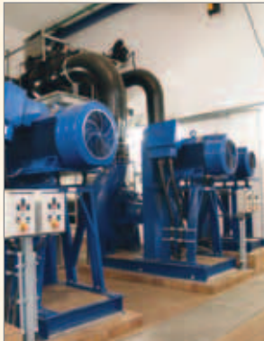
Bild 25 – Zentralkläranlage Freiberg 2006, Zulaufpumpenwerk, 1998 in Betrieb genommen
