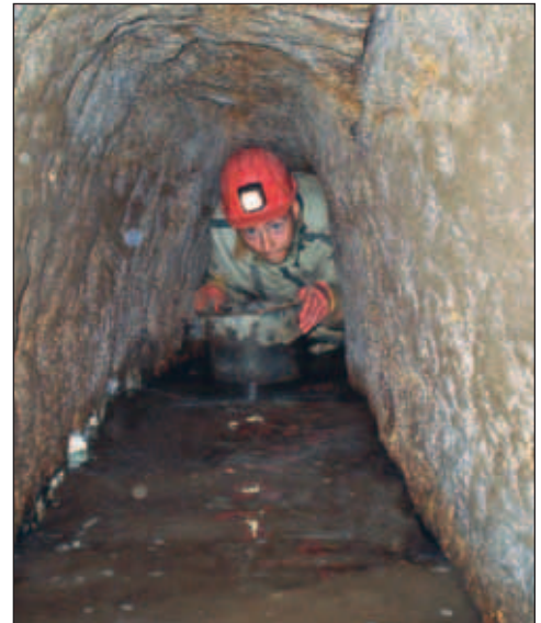
Schadstellenerkundung in der Hauptanzucht Weingasse in Freiberg bei räumlich extremen Bedingungen
