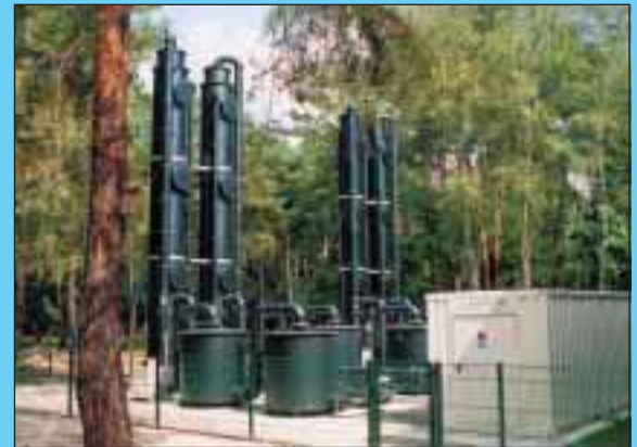
Desorptionsanlage im Wasserwerk Ludwigsfelde
