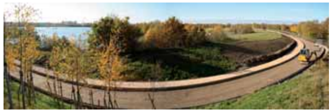
Oktober 2009 – Der 2,3 Kilometer lange Rundweg um den See nimmt Formen an. Teile des Betonloops sind bereits gegossen.
