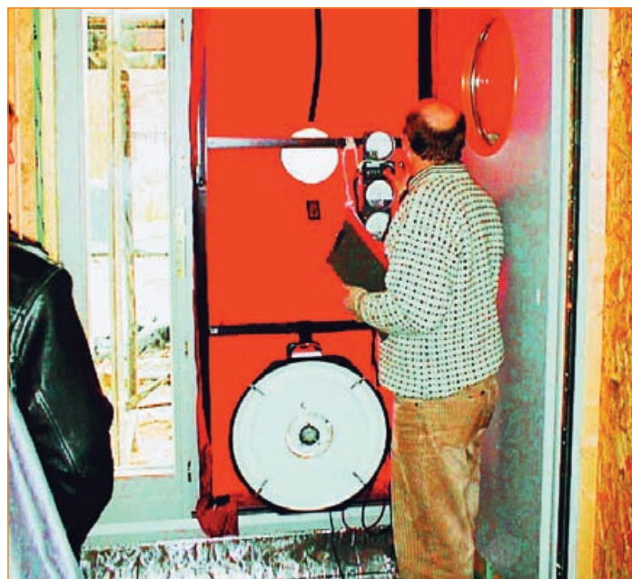
Eine hohe Gebäudeluftdichtigkeit - überprüft durch einen Blower-door-Test - schützt vor späteren Bauschäden.
