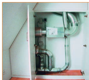
Lüftungsanlagen werden platzsparend installiert und arbeiten sehr leise.
