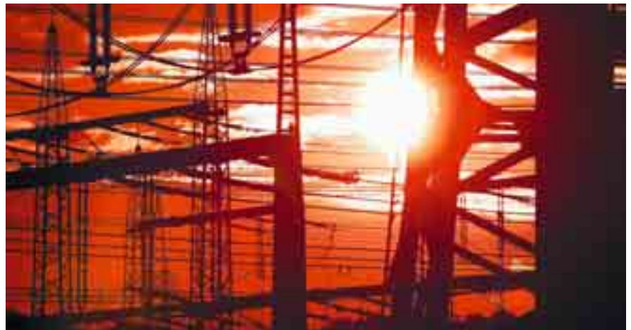
Umspannwerk Transformer station
