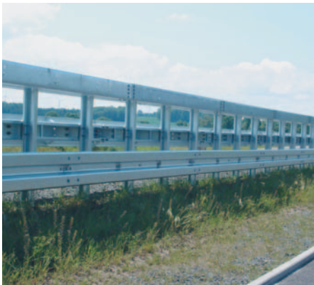
Mittrennung der Fahrbahn durch das System SUPER-RAIL
