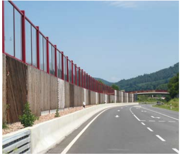
Bis zu 5 Meter hohe Schallschutzwände an der St 507 in Bürgstadt (Bild: StBA AB)
