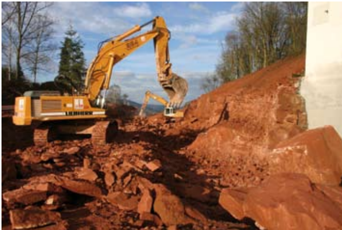
Ausbruch von Felsmaterial im Tunnelabschnitt (Bild: StBA AB)
