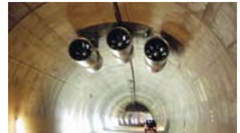
Strahlventilatoren im Tunnelgewölbe
