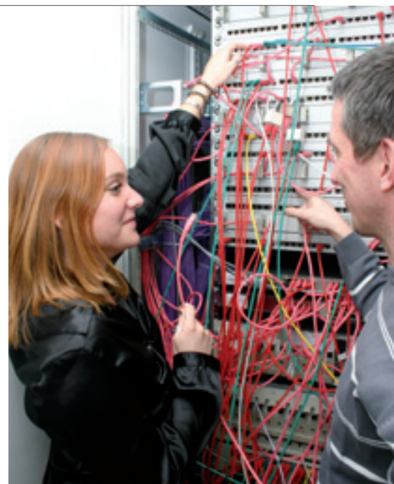
Stephanie Heim beim Schalten eines DSL-Anschlusses am Server unter Beobachtung ihres Lernprozessbegleiters Peter Dörrzapf.
