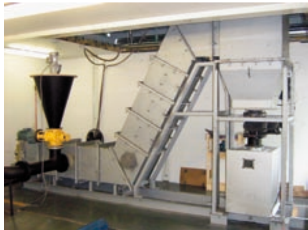
Bild 5.1-2: Hochtemperaturteil mit Materialeintrag und Aschebehälter
