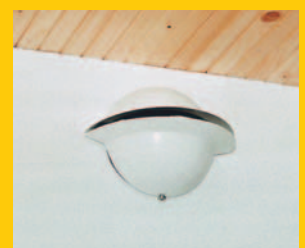
Nur diese Lüftungsdüse kann man von einer Komfortlüftung sehen.
