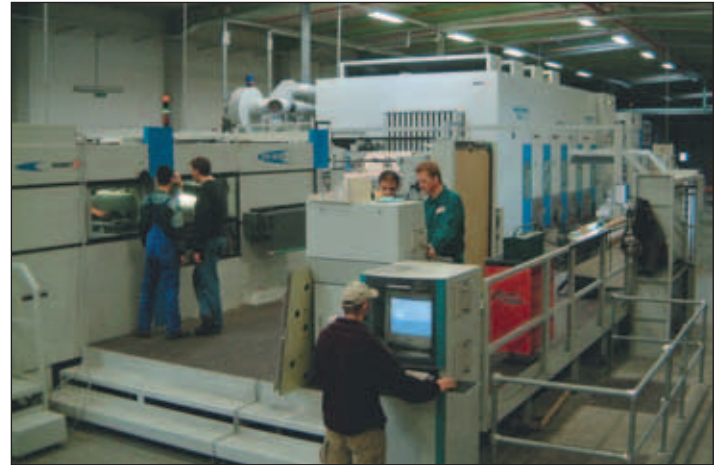
Produktionsanlage Firma Klingele Papierwerke, Hilpoltstein
