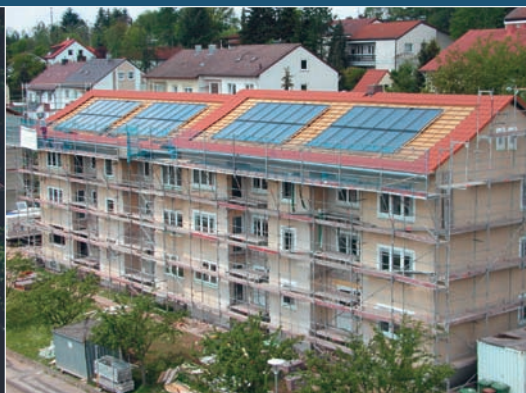
Integration einer Solaranlage in die Dachfläche
