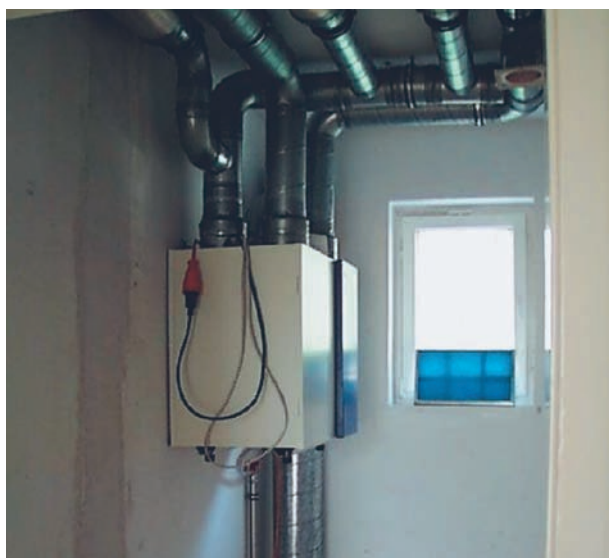
Zentrales Lüftungsgerät und Filtereinsatz
