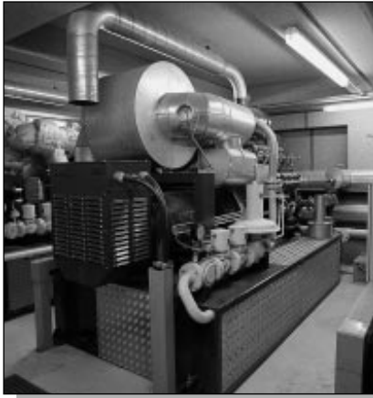
BHKW (Blockheizkraftwerk) im Schulviertel Hagenau
