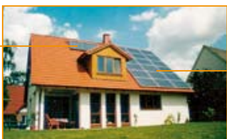
Wärme von der Sonne Thermische Solaranlage
