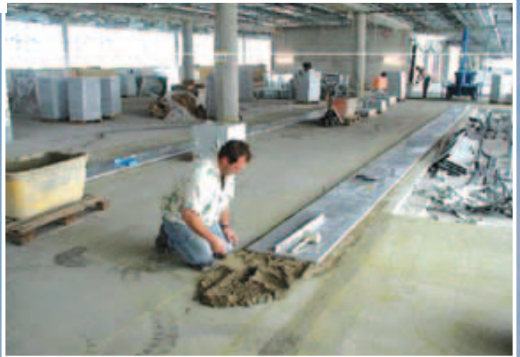
Großauftrag am Airport München, Terminal II: Fliesen Fritsch in Altenschwand mit hoher Reputation in Sachen Naturstein.
