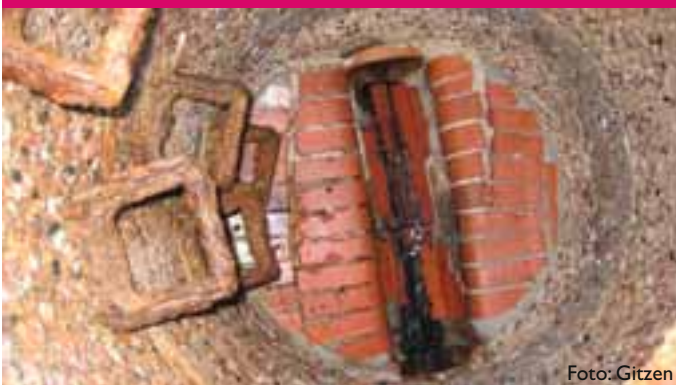
Abb.2: Sorgenkind Kanalschacht → BSK-Angriff (PH I)
