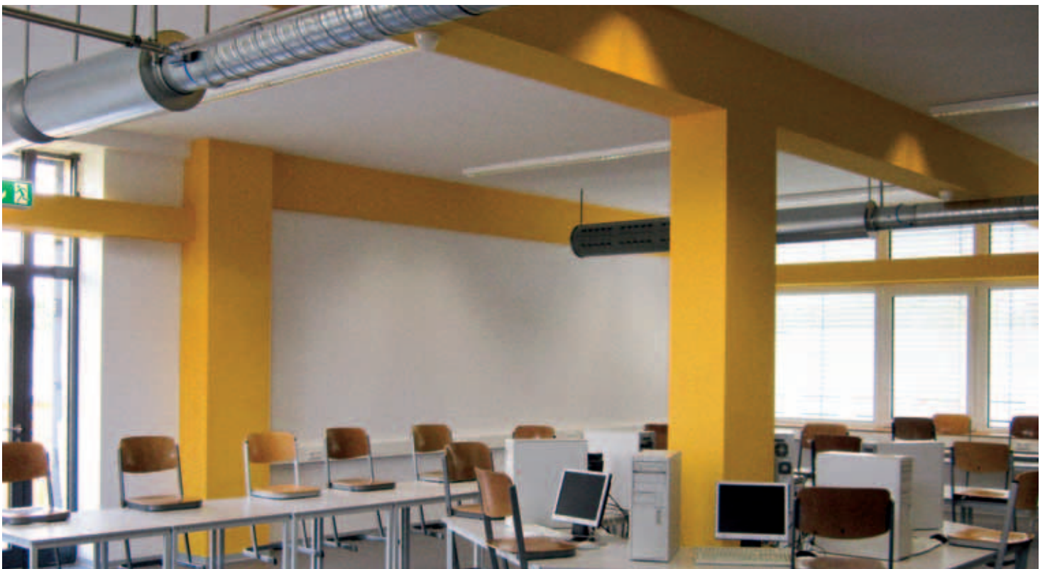
Moderne Lüftungstechnik im Gymnasium Baesweiler
