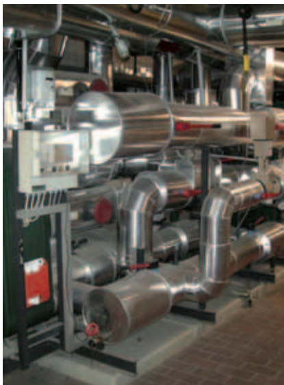
Mittels dieser Übergabestation wird das Kreiskrankenhaus seit zehn Jahren mit Geothermiewärme versorgt
