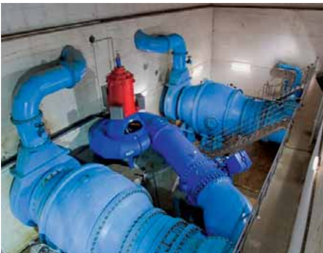
Foto: Wasserkraftanlage Talsperre Wendefurth
