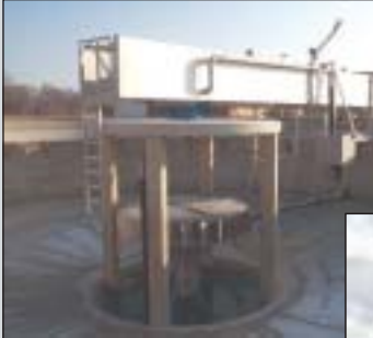
Verbandskläranlage Hoym / Nachterstedt
