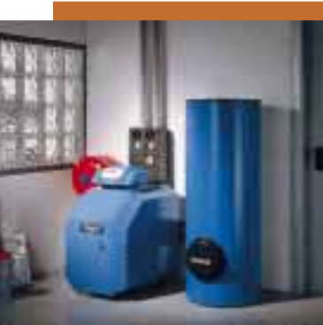
Solaranlagen lassen sich auch beim nachträglichen Einbau optimal in die vorhandene Heizungsanlage integrieren.
