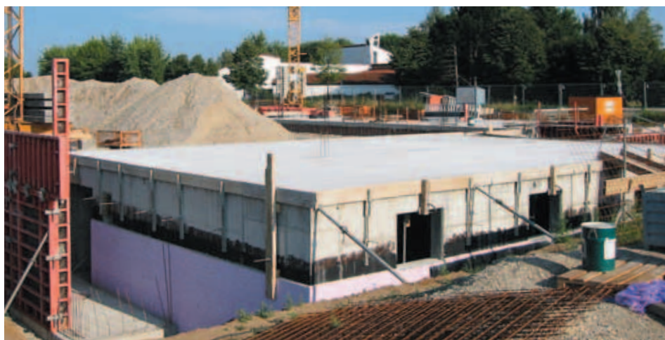
Keller müssen gedämmt sein
